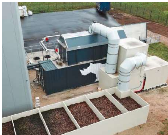
Abbildung 6 Trockner, Abluftwäscher und Biofilter im Zusammenspiel am Standort einer dezentralen Klärschlamm-trocknung und -verbrennung ©Werkstätten GmbH
