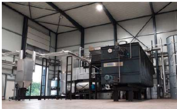
Abbildung 7 Klärschlammverbrennungslinie 500 kW mit vorgeschaltetem Trockenschlamm-bunker zur Entkopplung von Trocknung und Verbrennung ©Werkstätten GmbH
