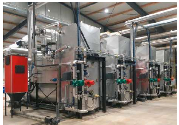
Abbildung 1 Modulare Aufstellung mit 4 Drehrohrkesseln à 500 kW ©Werkstätten GmbH
